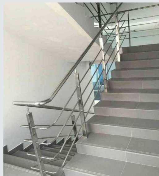
CẦU THANG INOX SUS STAIRCASE
